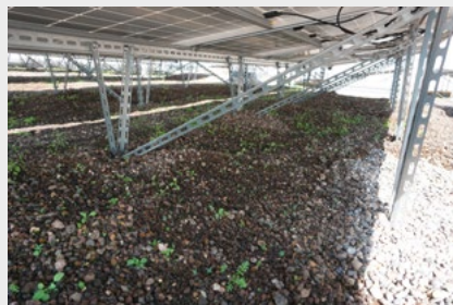
Die PV-adaptierte Begrünung wächst bereits. Dank niedrigwachsender Pflanzen beeinträchtigt sie die PV-Leistung nicht.
