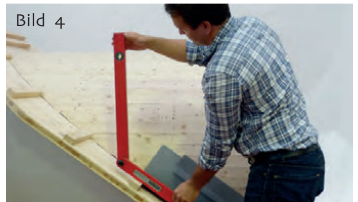
Bild 4 Messen der Dachneigung auf der Dachlattung mit Winkelmesser (weitere Aufmaßmöglichkeiten unter www.krehle.de ).
